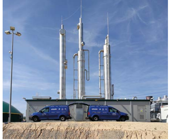
Biogas-Aufbereitung von Schwelm Anlagentechnik
