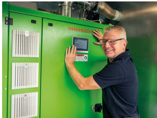
Stefan Stracke, Leiter Gashochdruck in der Anlagentechnik von AVU Netz, kontrolliert den Elektrolyseur der Versuchsanlage
